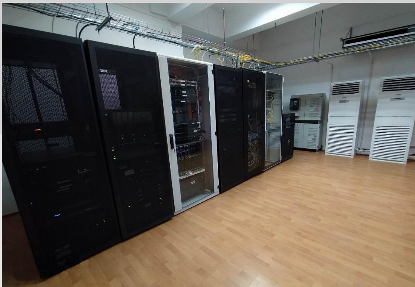
Echipamente de date din Centrul de Comunicatii U.P.T.
